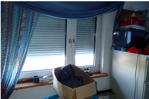
Abb. 12: Die ehemaligen Wohnräume waren für Fledermäuse aufgrund geschlossener und intakter Fenster nicht zugänglich.
