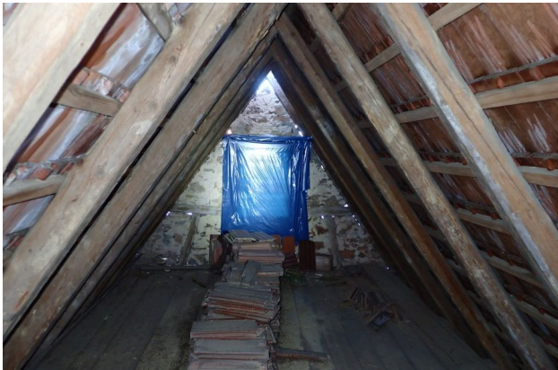
Abb. 18: Der Giebel vom Inneren des Dachstuhl aus gesehen. Einzelne Löcher sind lediglich Durchlässe ohne Quartierstrukturen.
